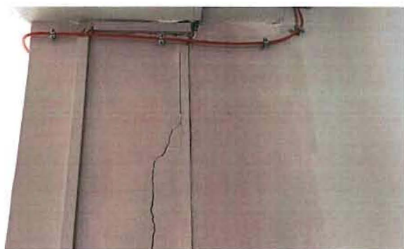
Slika 1. Karakteristično oštećenje: Pukotine kao posledica nadziđivanja.
